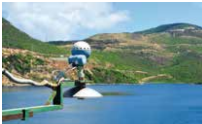
Station de mesure
