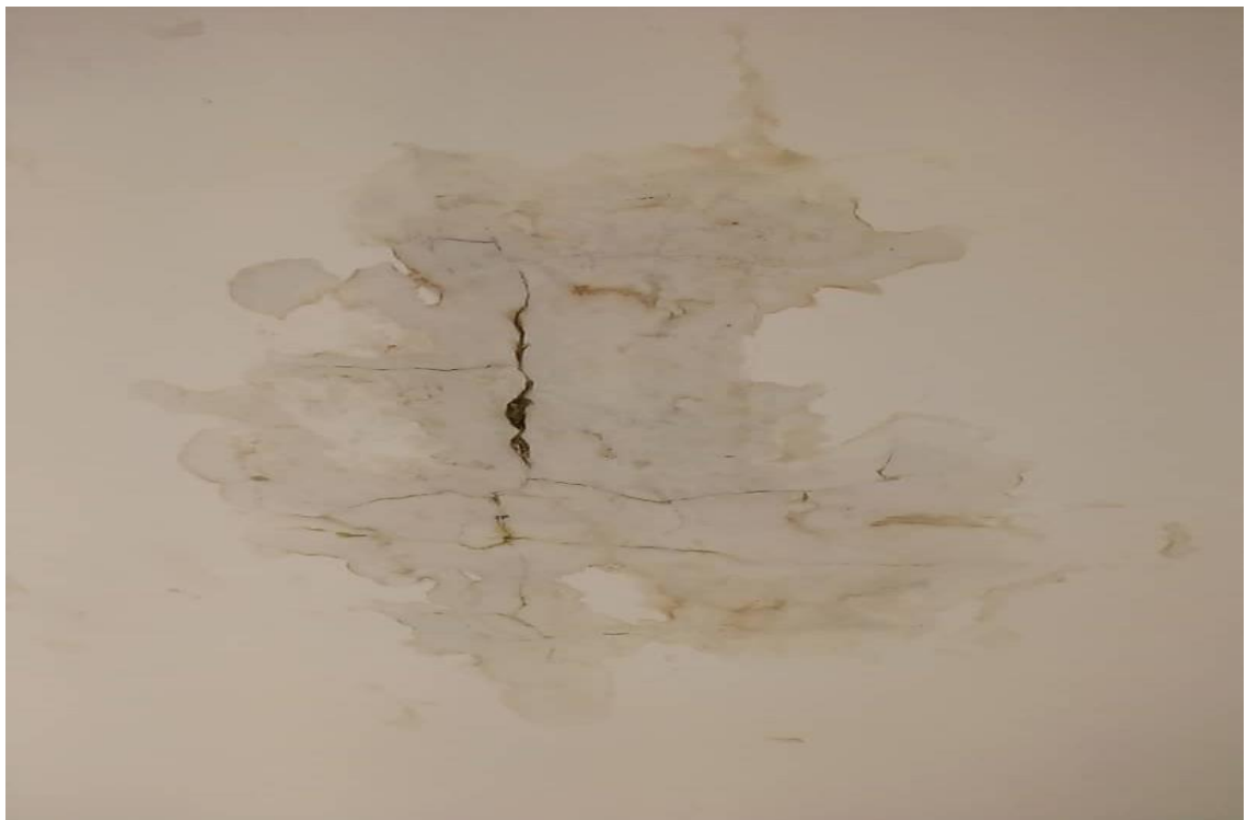
Photos Vue sur fissures existantes et trace humidité à corriger
