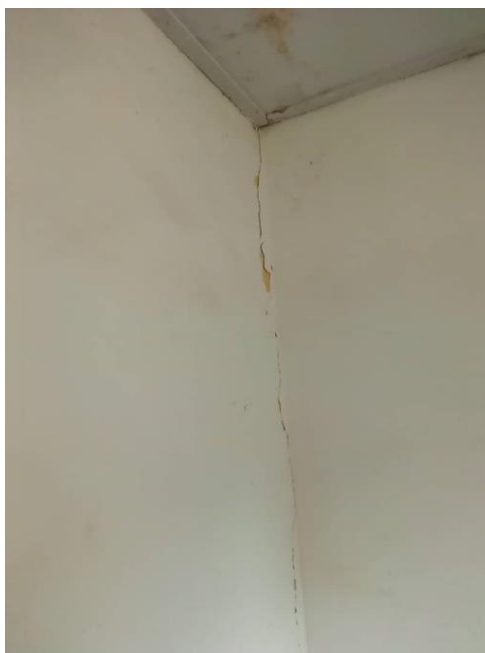
Photo : Vue sur fissures existantes à corriger
