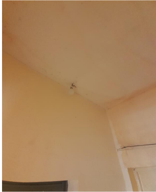
Photo : Vue sur les traces d'humidité
