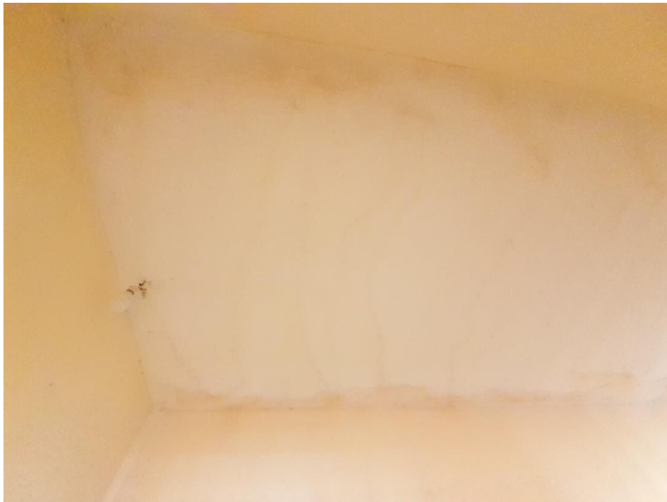
Photo : Vue sur les traces d'humidité
