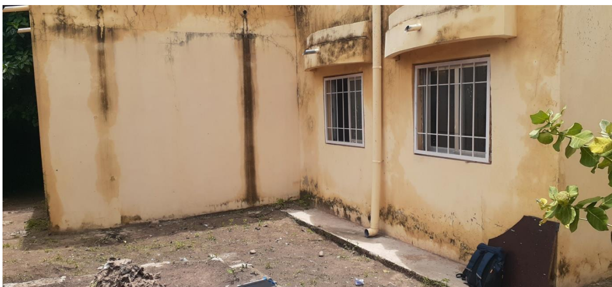
Photo : Vue sur traces d'humidité sur les murs de façade
