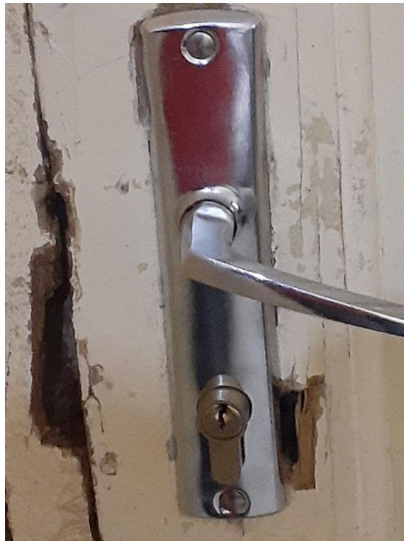
Photo 9 : menuiseries Porte et serrure à changer
