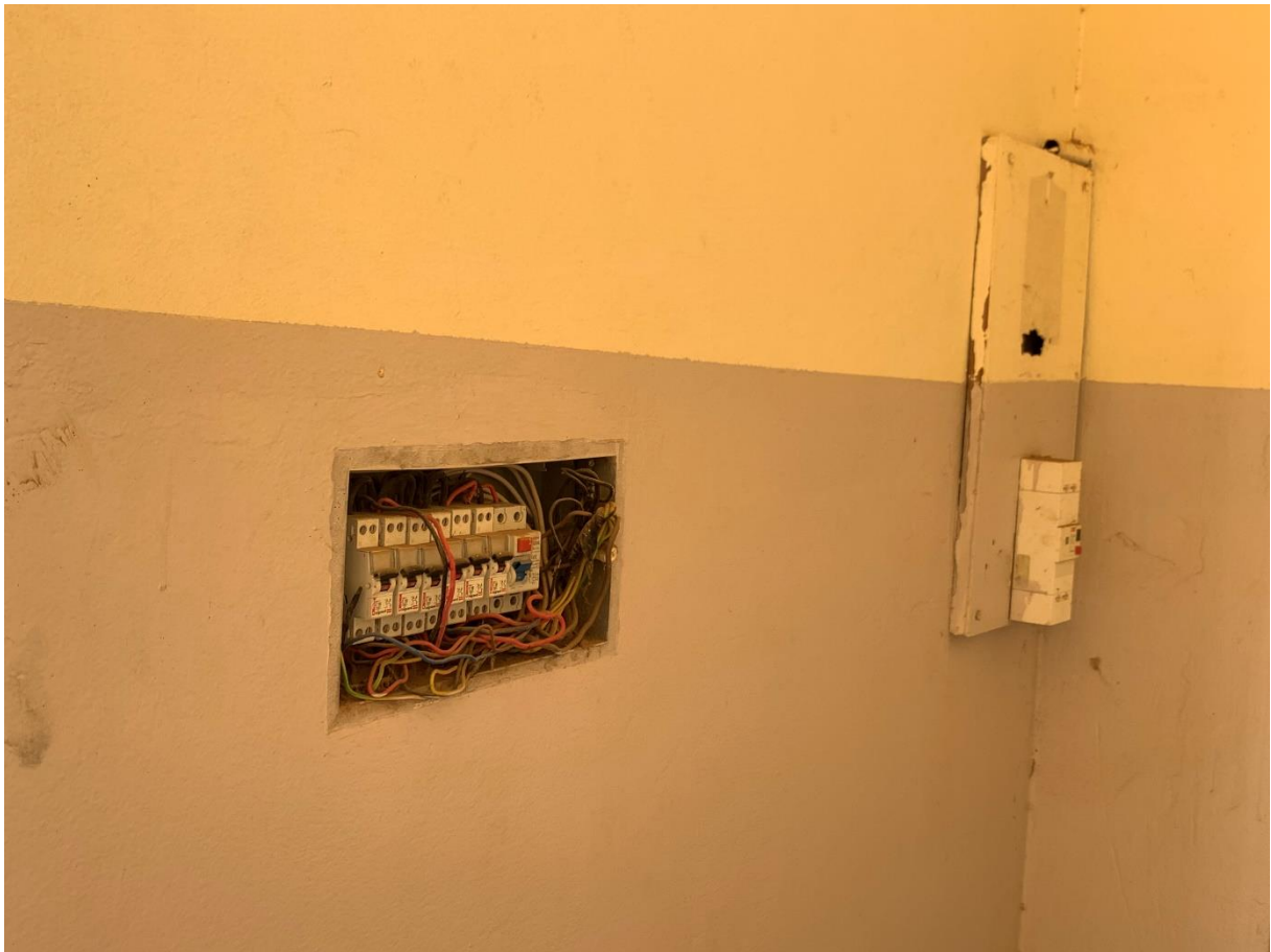
Photo : Vue sur le compteur pour électricité et le coffret
