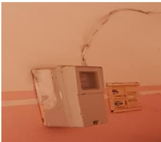
Photo : Vue sur une installation apparente du réseau électrique à corriger
