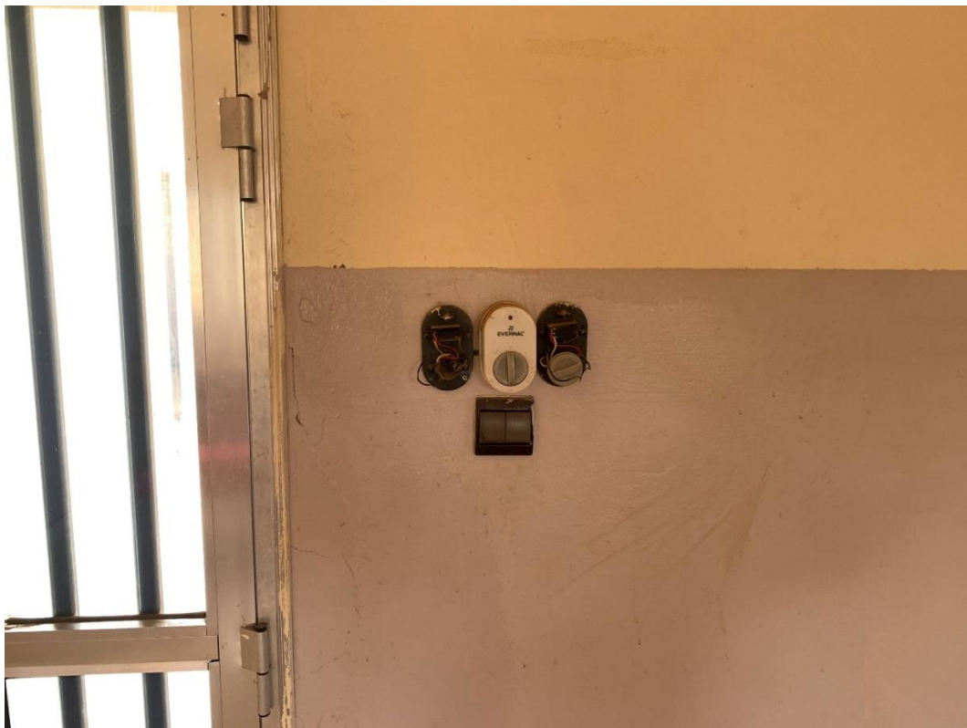
Photo : Vue sur la prise et des fils électrique à corriger
