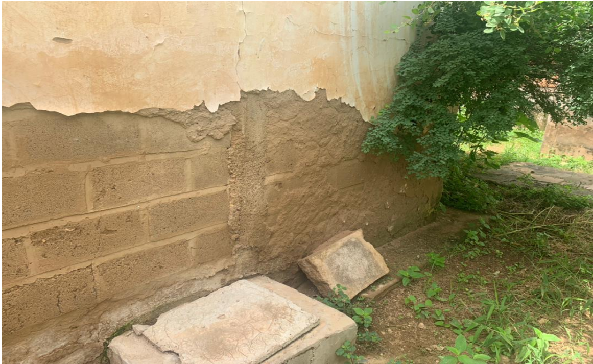
Photo Vue sur l'enduit mur façade à corriger
