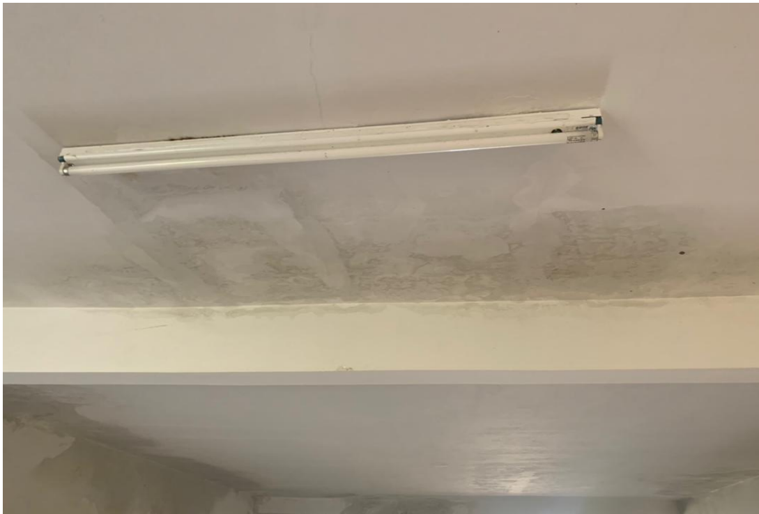
Photo : Vue sur les traces d'humidité sur les parois à corriger
