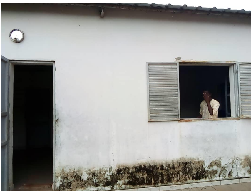
Photo : Vue sur l'enduit mur façade salle d'archive n2 à corriger
