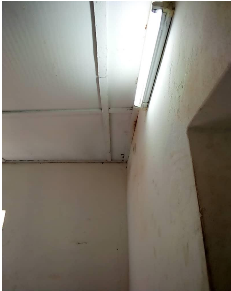
Photo : Vue sur les traces d'humidité sur les parois à corriger
