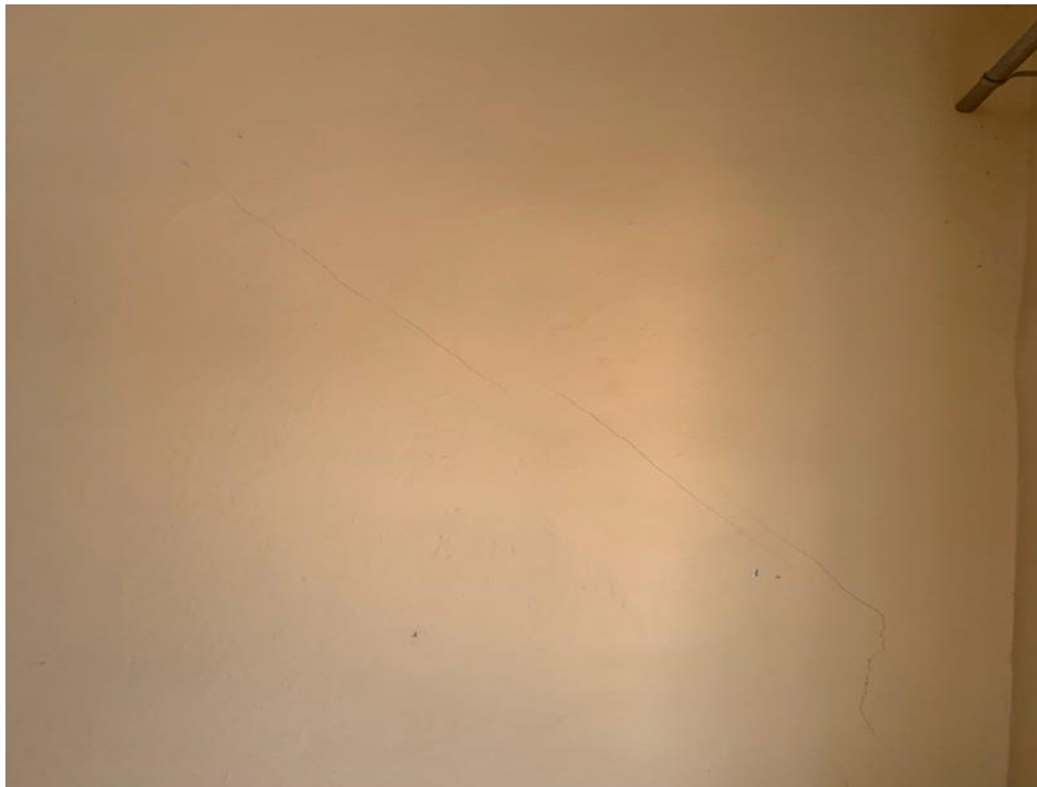
Photo Vue sur fissures existantes à corriger
