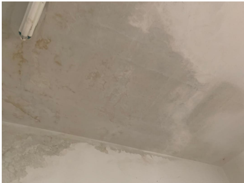
Photo Vue sur des traces d'humidité
