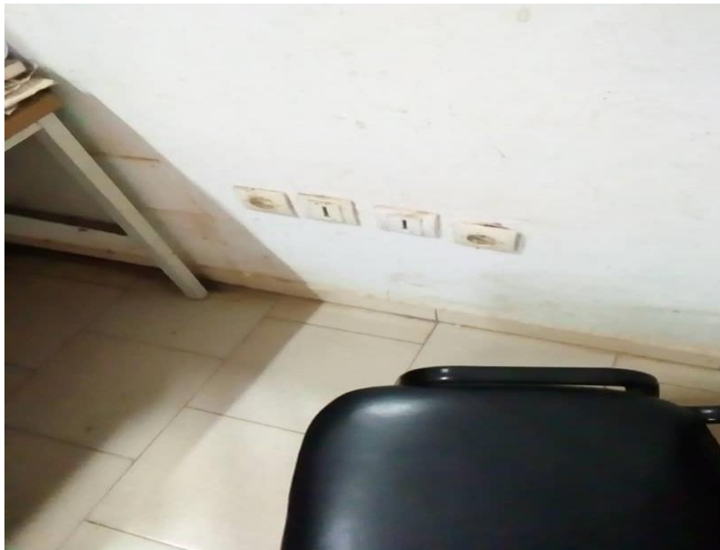
Photo : Vue sur des prises défectueux à corriger
