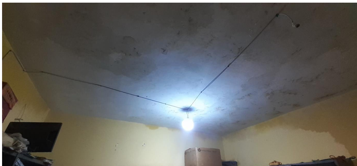
Photo : Vue sur une installation apparente du réseau électrique à corriger par des goulottes
