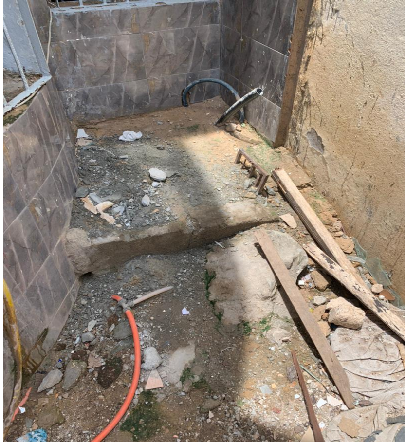
Photo Vue sur l'enduit mur façade à corriger
