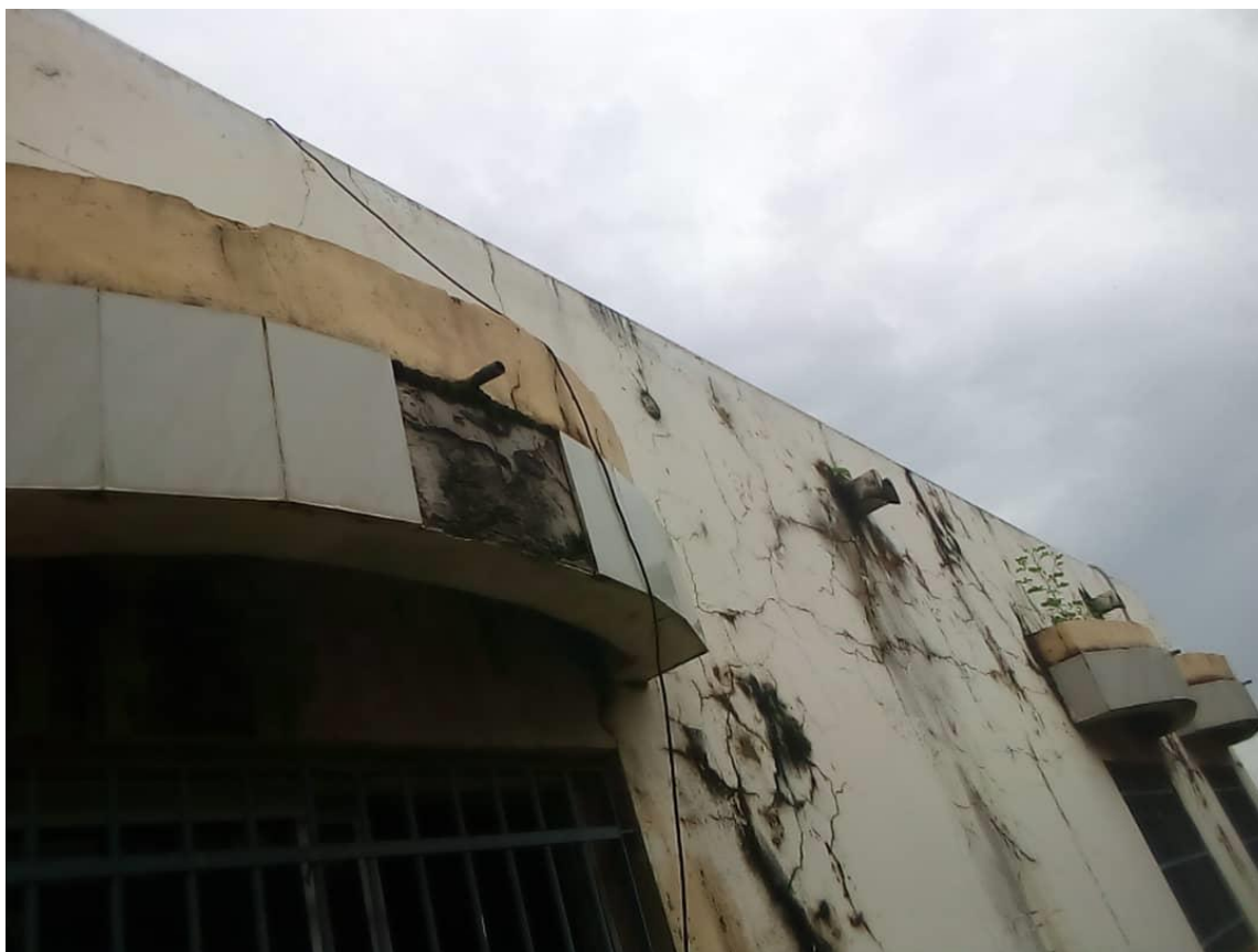
Photo Vue sur l'enduit mur façade à corriger
