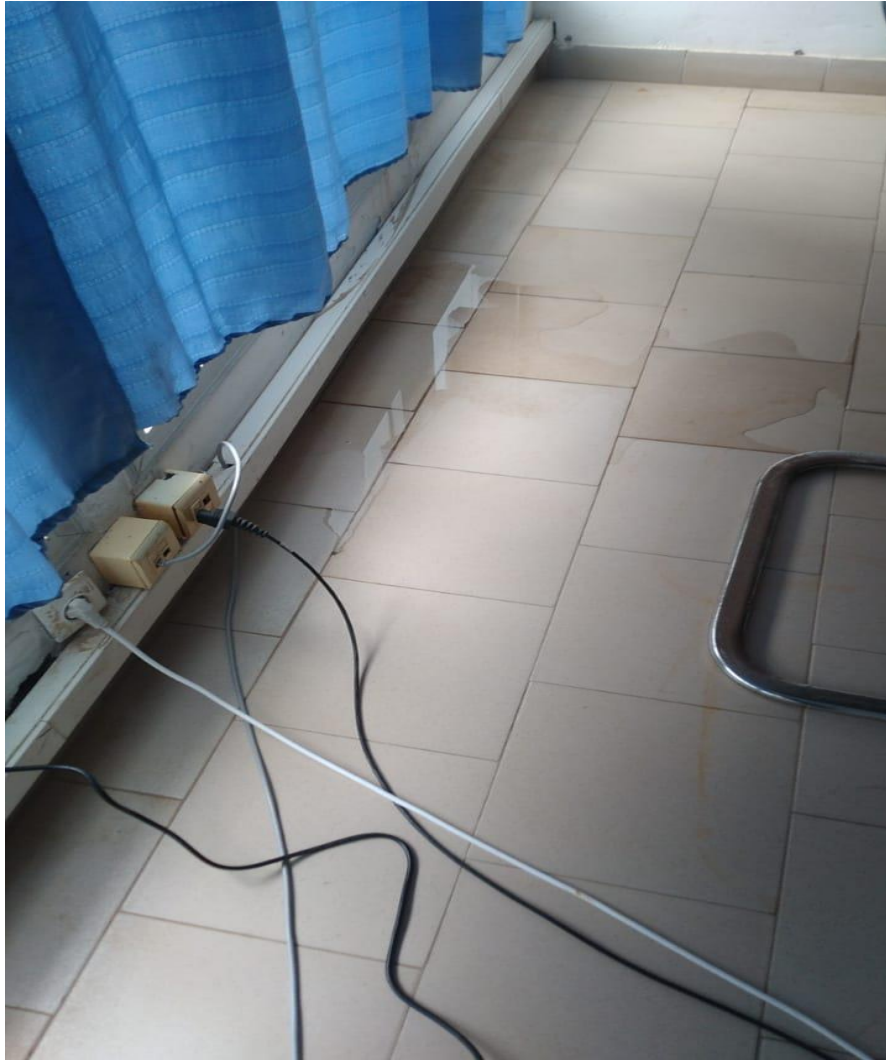
Photo 2 : Vue sur une prise et des fils électriques à corriger
