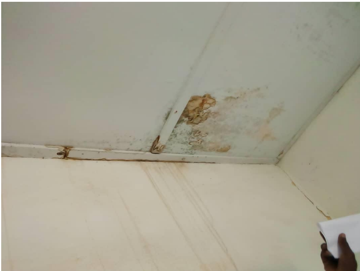
Photo : Vue sur des traces d'humidité
