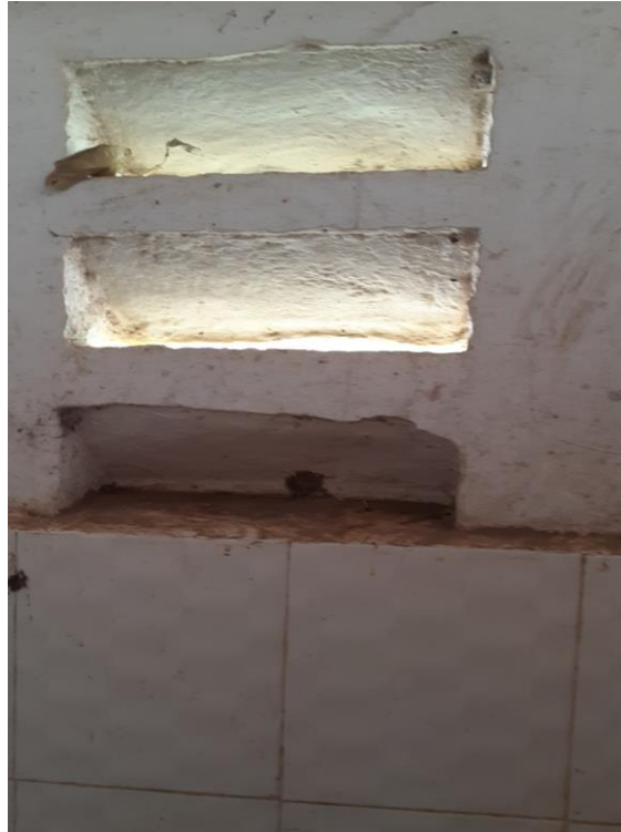
Photo : Vue sur fenêtre toilette à remplacer par une fenêtre 60/100
