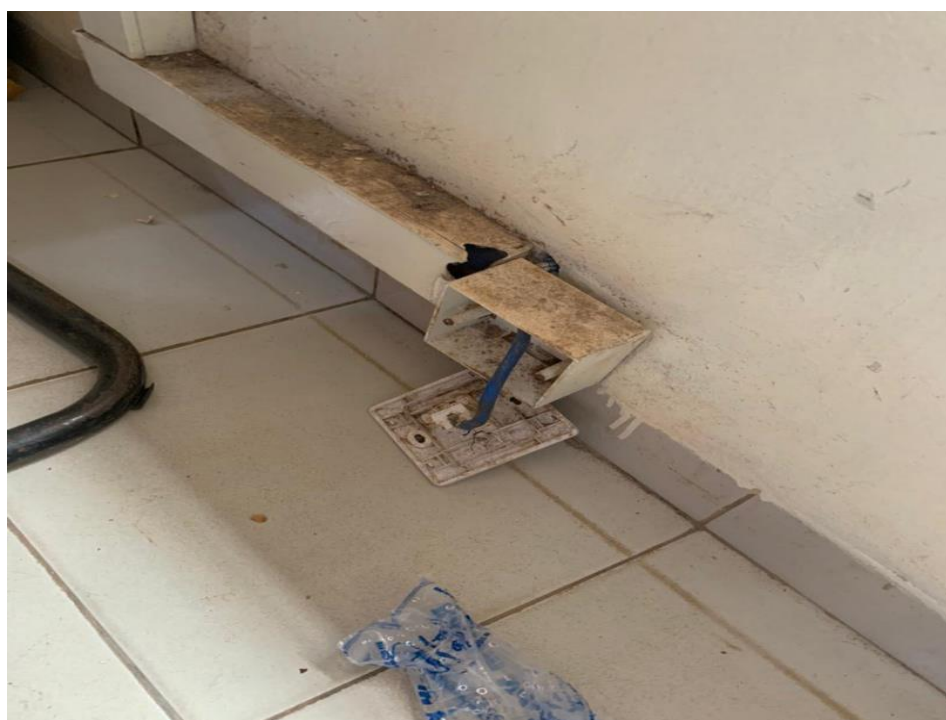
Photos Vue sur une prise et des fils électriques défectueux à corriger
