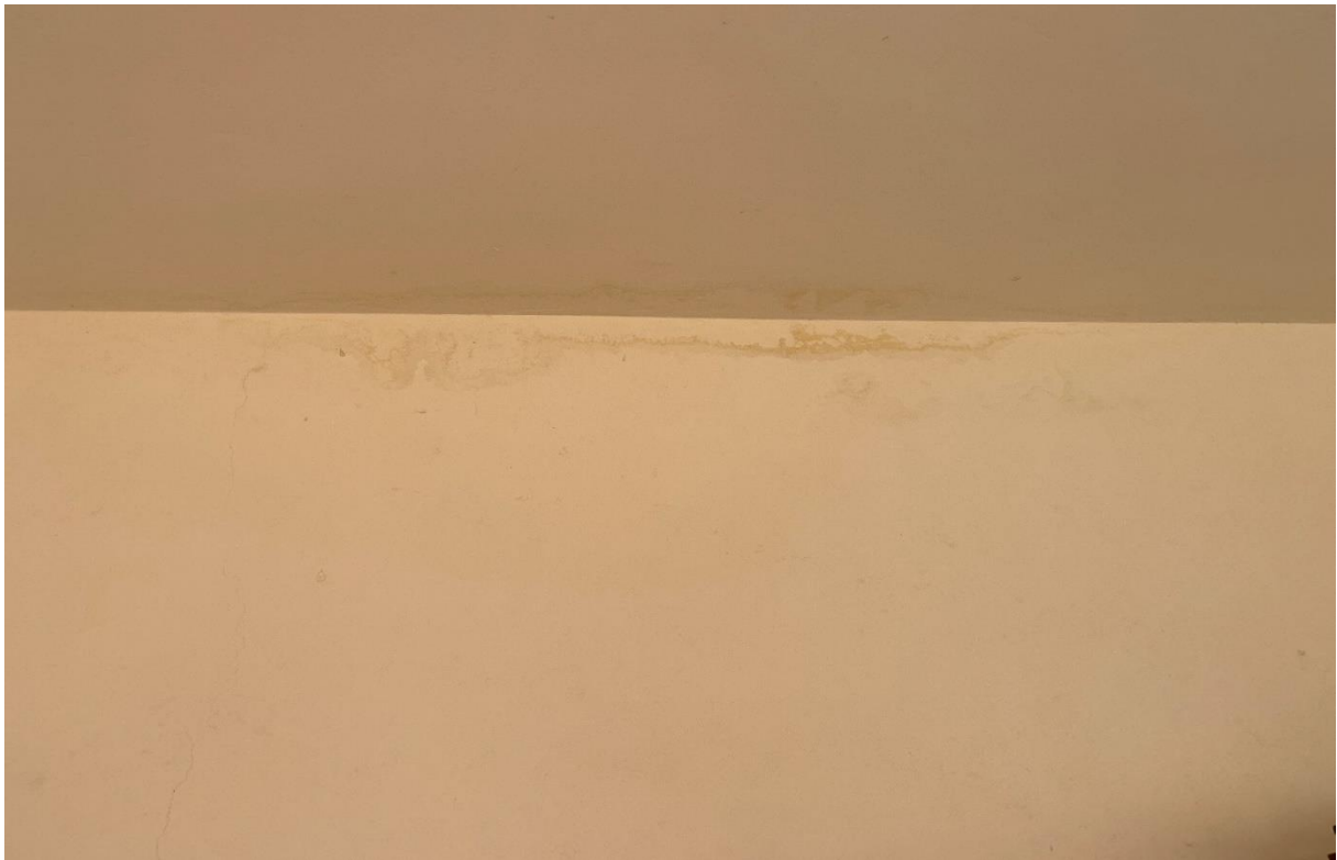
Photos Vue sur des traces d'humidité
