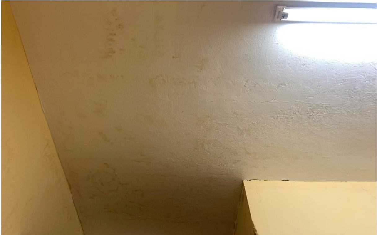
Photos : Vue sur des traces d'humidité
