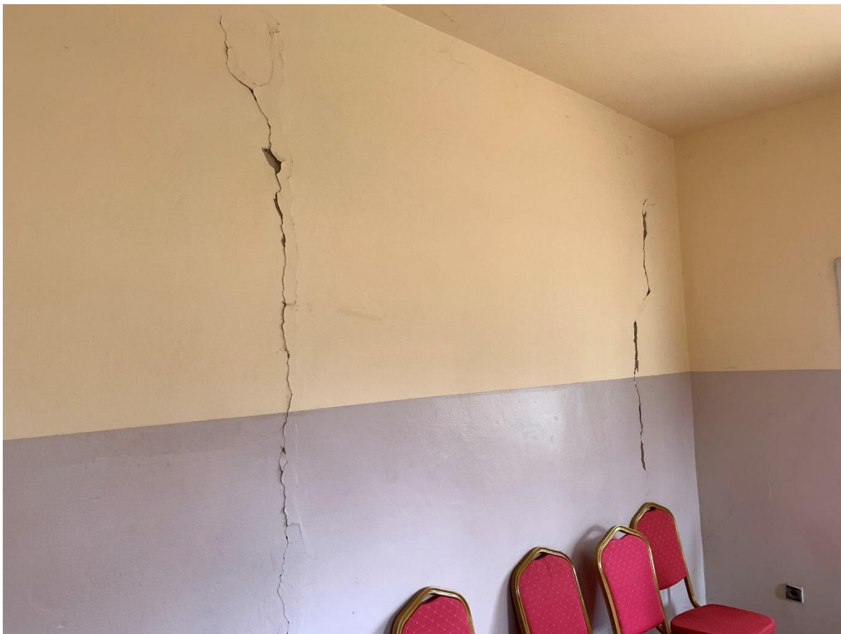
Photos Vue sur fissures existantes à corriger
