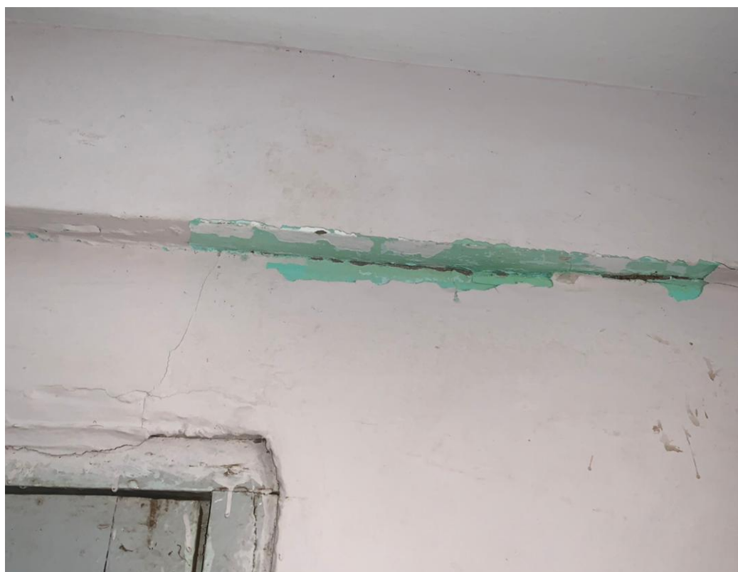
Photos Vue sur fissuration des murs
