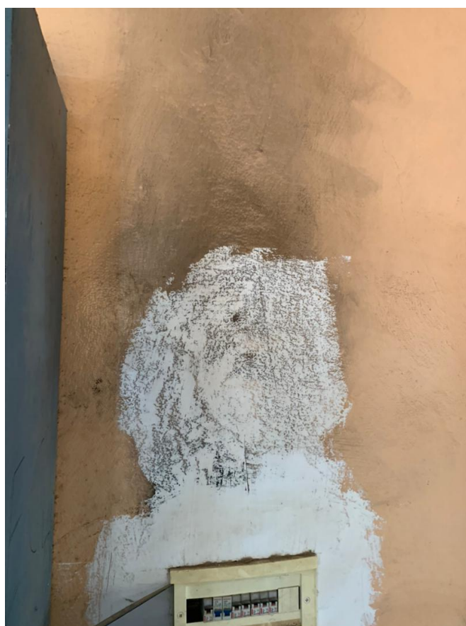
Photos Vue sur le coffret après l'incendie de la salle d'archivage
