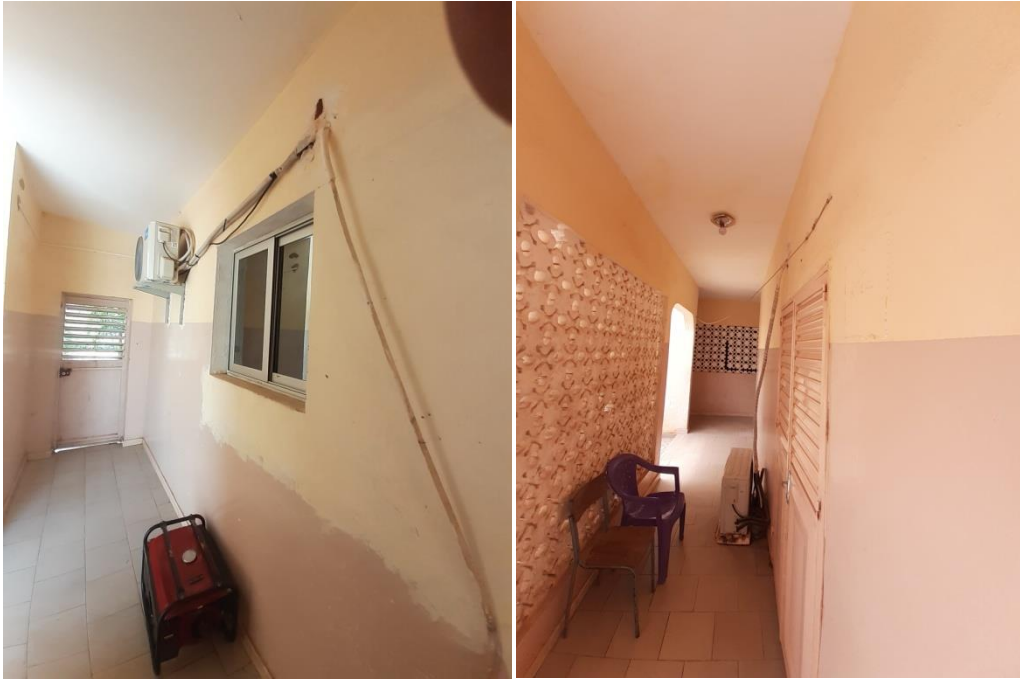
Photo vue sur une installation électrique apparente à corriger par des goulottes
