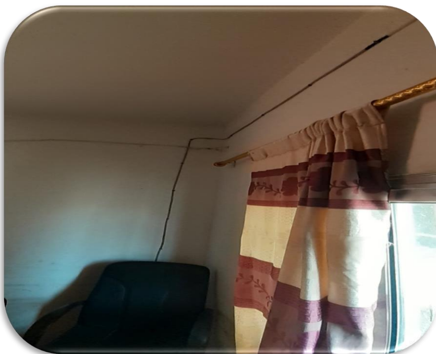
Photo : Vue sur une installation apparente du réseau électrique à corriger par des goulottes
