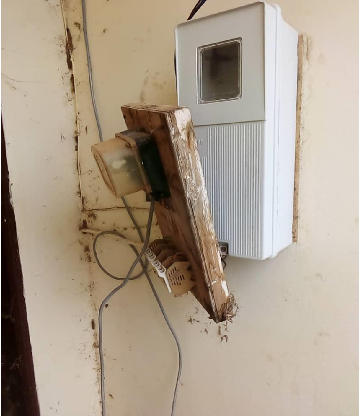
Photo Vue sur l'état du compteur électrique du bâtiment
