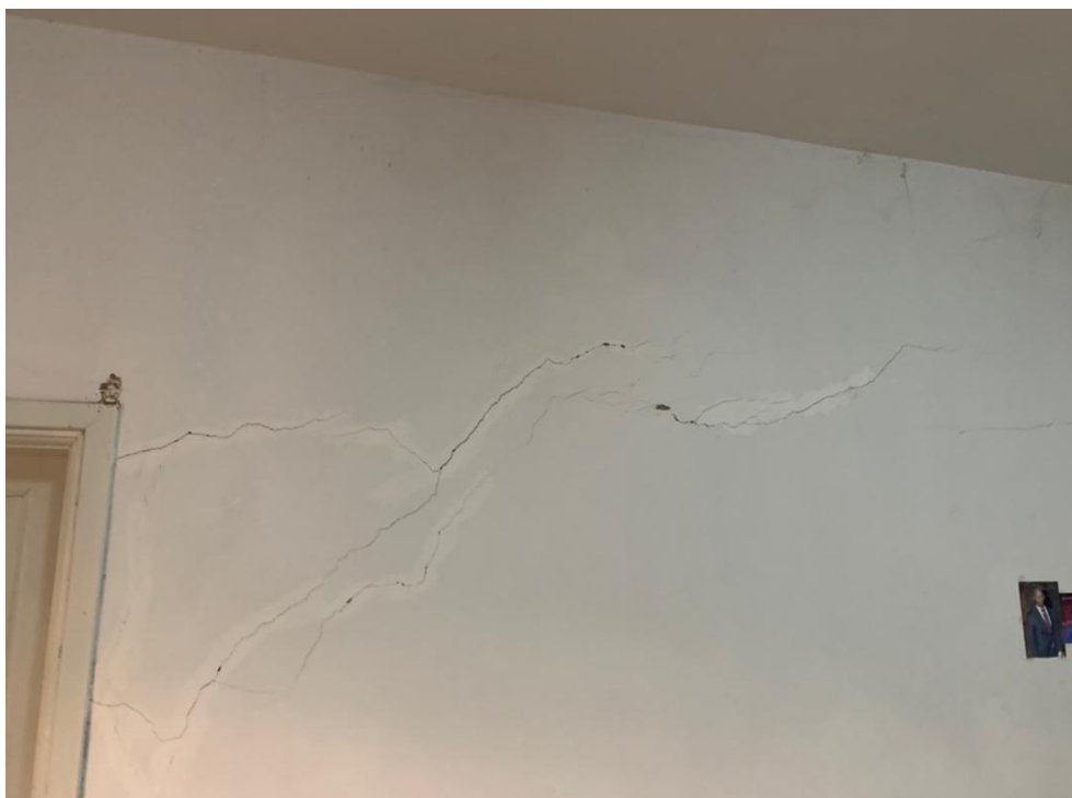
Photo Vue sur fissures existantes à corriger
