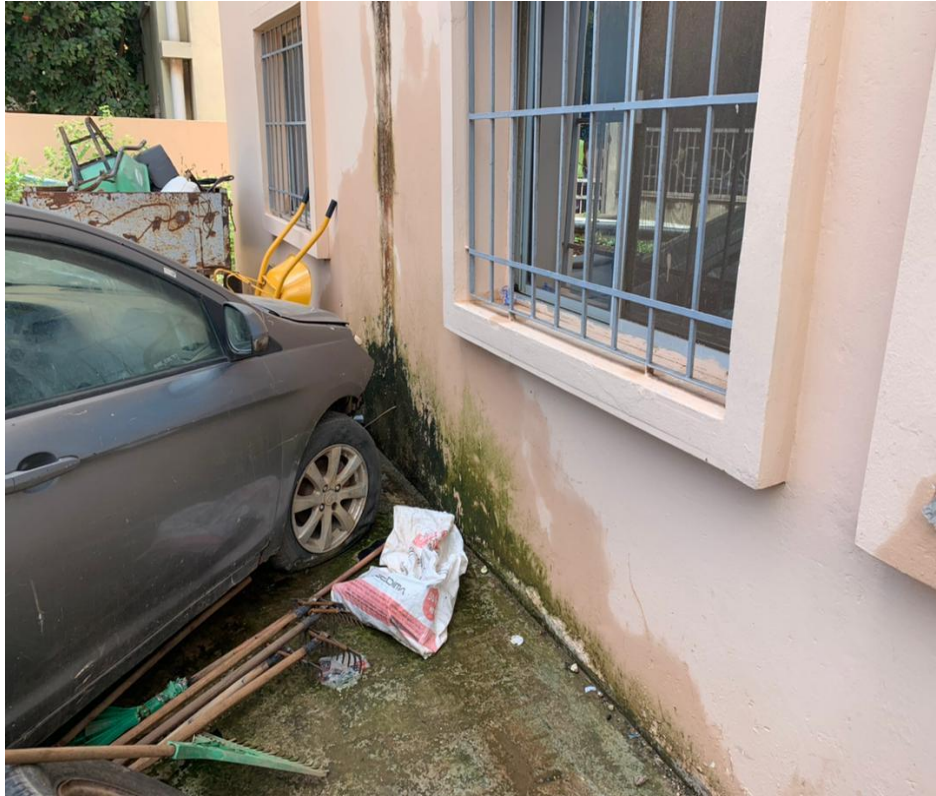
Photo Vue sur les traces d'humidité ascensionnelle
