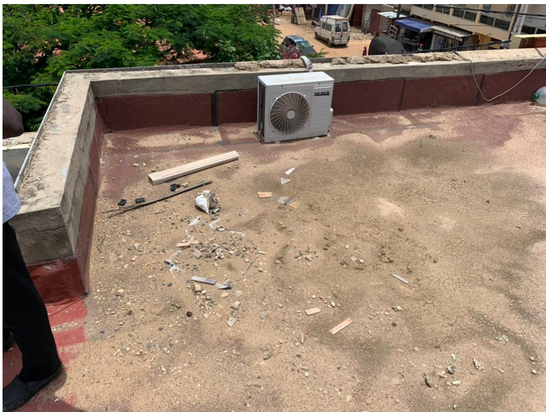
Photos Vue sur des traces d'humidité et sur la toiture
