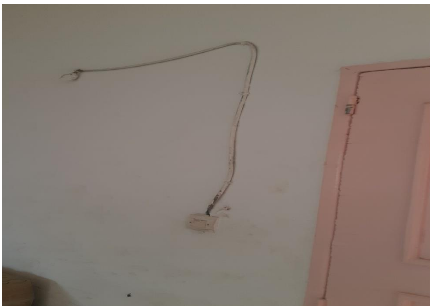
Photo : Vue sur une installation apparente du réseau électrique à corriger par des goulottes
