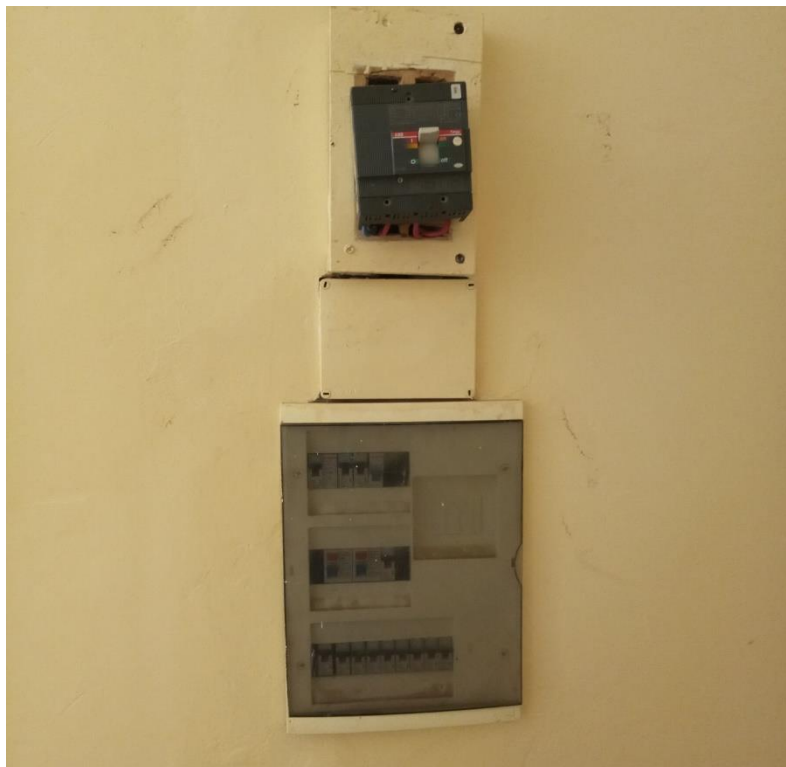
Photo 3 : Vue sur le coffret électriques défectueux à corriger.
