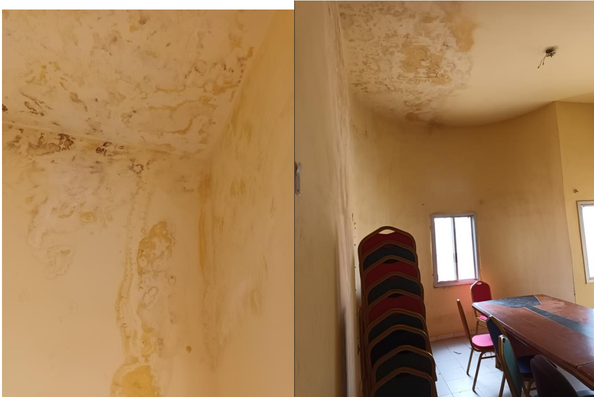
Vue sur les désordres constatés dans le centre d'état civil
