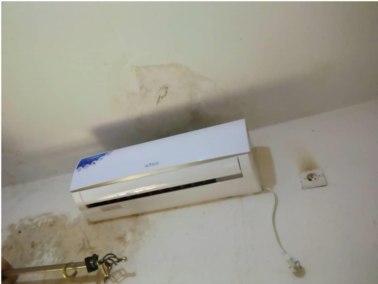
Photo Vue sur clim dégradée et à changer
