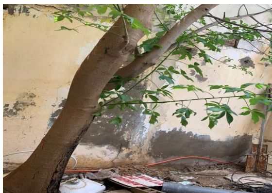
Photo : Vue sur les traces d'humidité sur les parois à corriger
