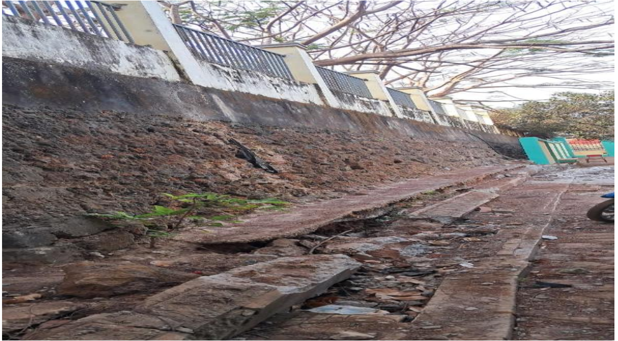
État actuel du mur de séparation avec l'ENPT à réhabiliter
