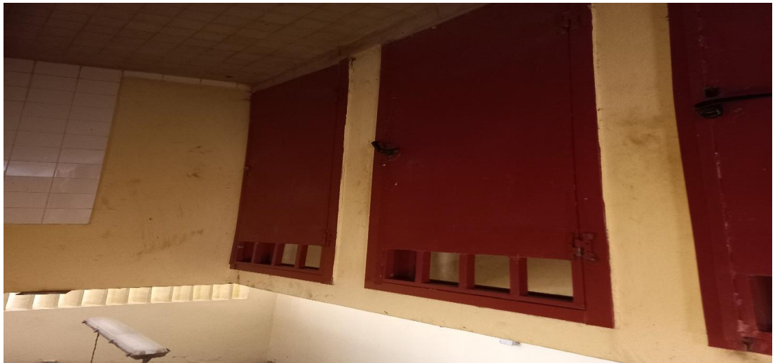
Etat actuel des cabines latrines des filles du CFP de Kindia
